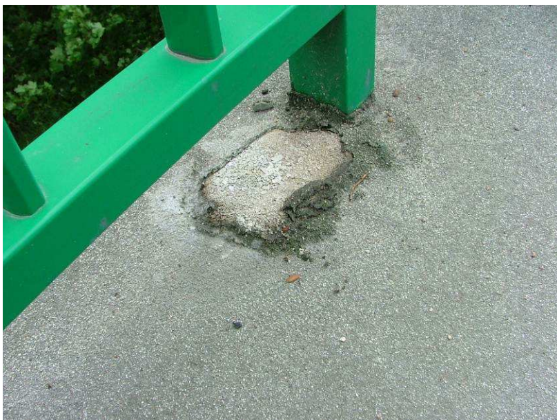
Fot. 41, 42 Nawierzchnia z żywicy na chodniku od strony południowej
