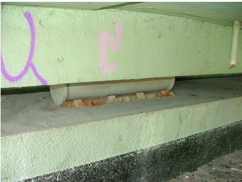
Fot. 36 Łożysko na przyczółku od stny Elbląga
