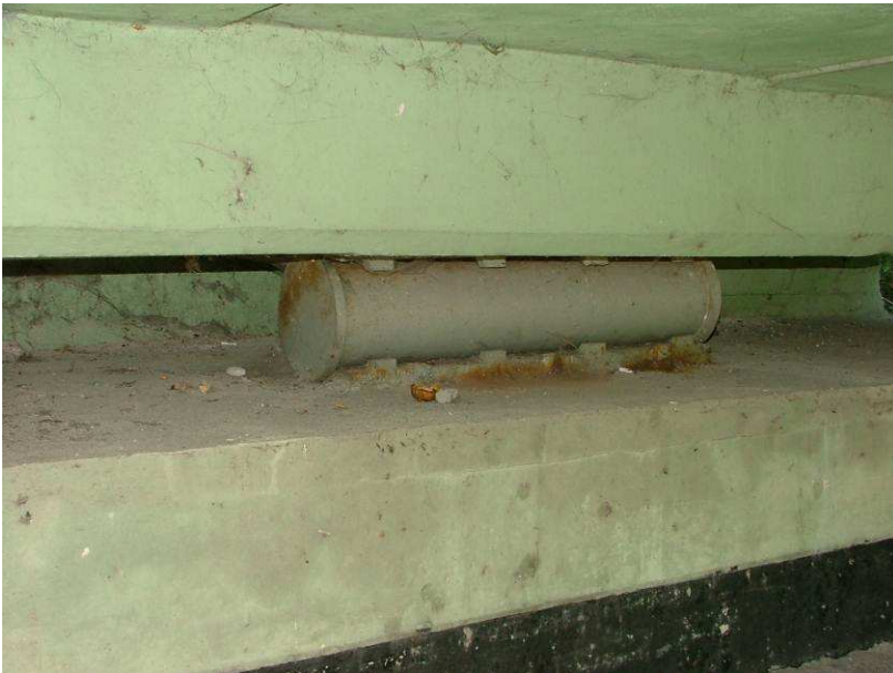
Fot. 34, 35 Łożyska na przyczółku od strony Gdańska
